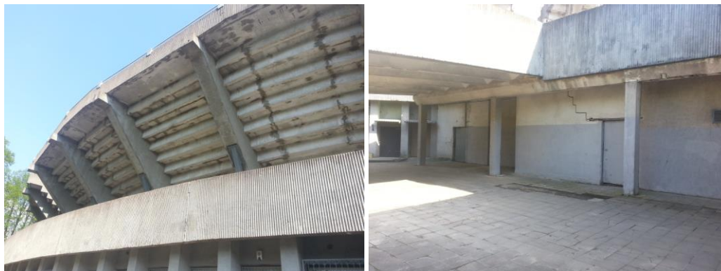
23 pav. Šiuo metu stadiono konstrukcijos ir apdaila yra fiziškai nusidėvėjusios
